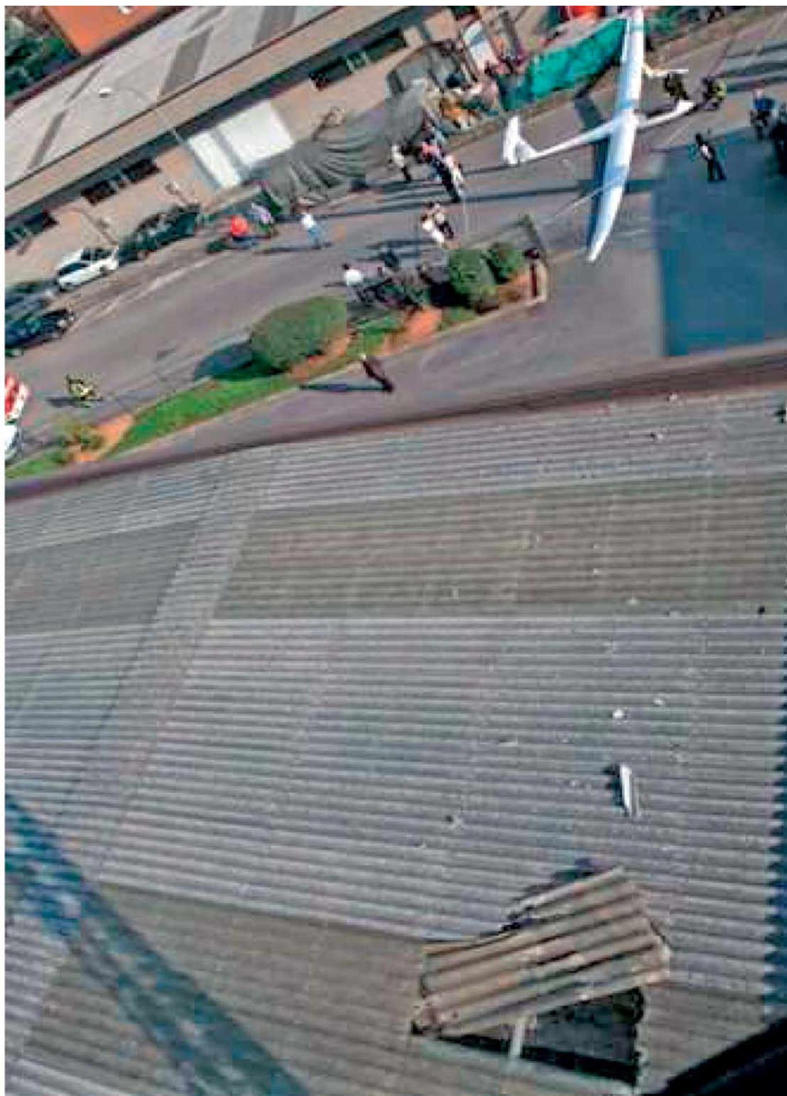
Primo piano del tetto del capannone contro il quale è avvenuto il primo impatto.
