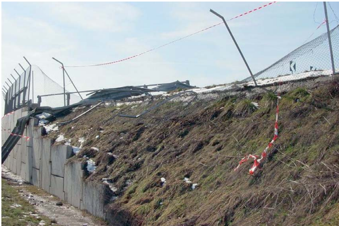
Foto n. 3: rottura guardrail e recinzione perimetrale.
