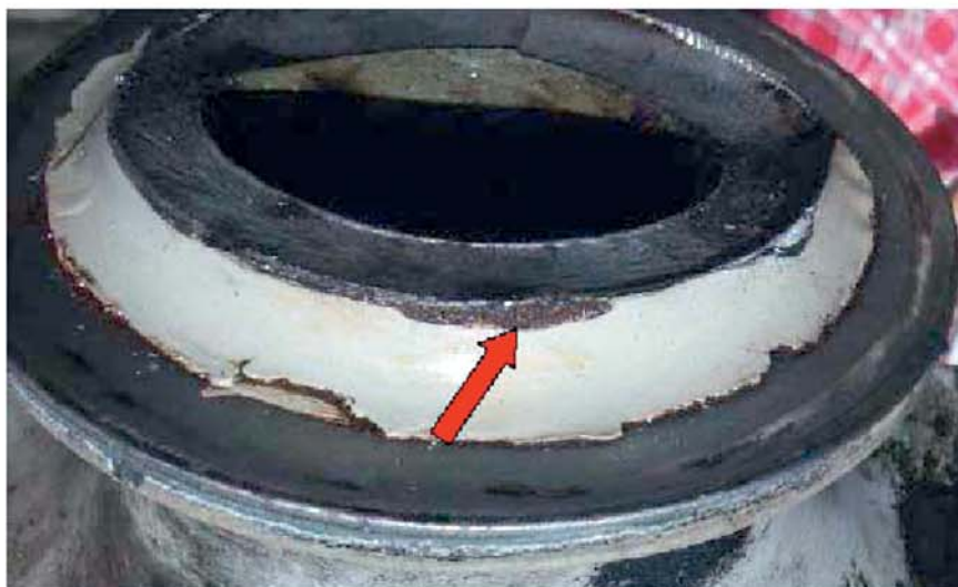
Figura 6 – Corrosione generalizzata della superficie esterna in corrispondenza dell'innesco
