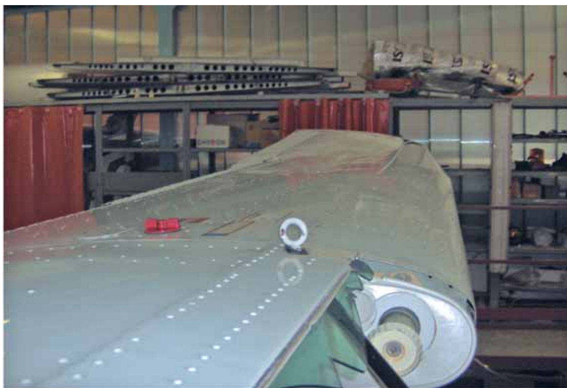
Danni all'ala sinistra.
