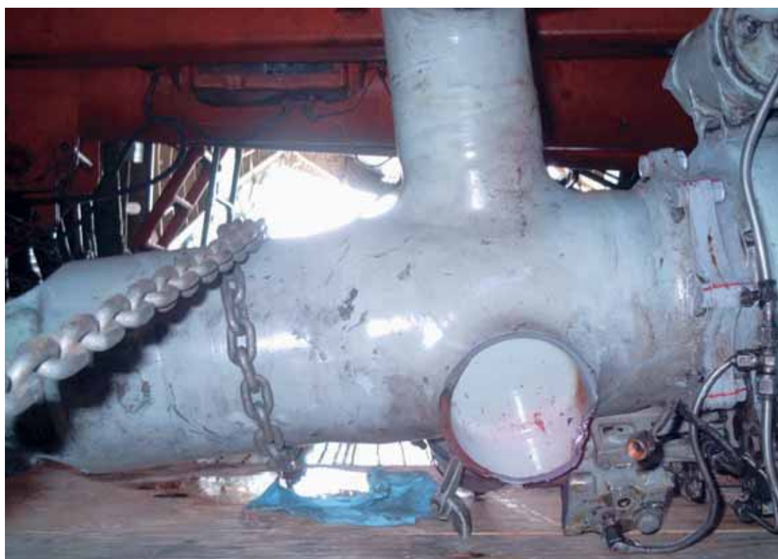
Sezione di rottura braccio di rotazione destro
