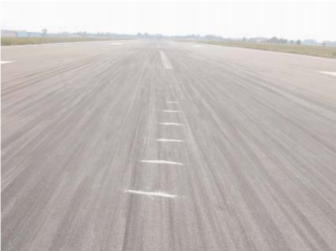
Abrasioni sul manto pista prodotte dall'elica
