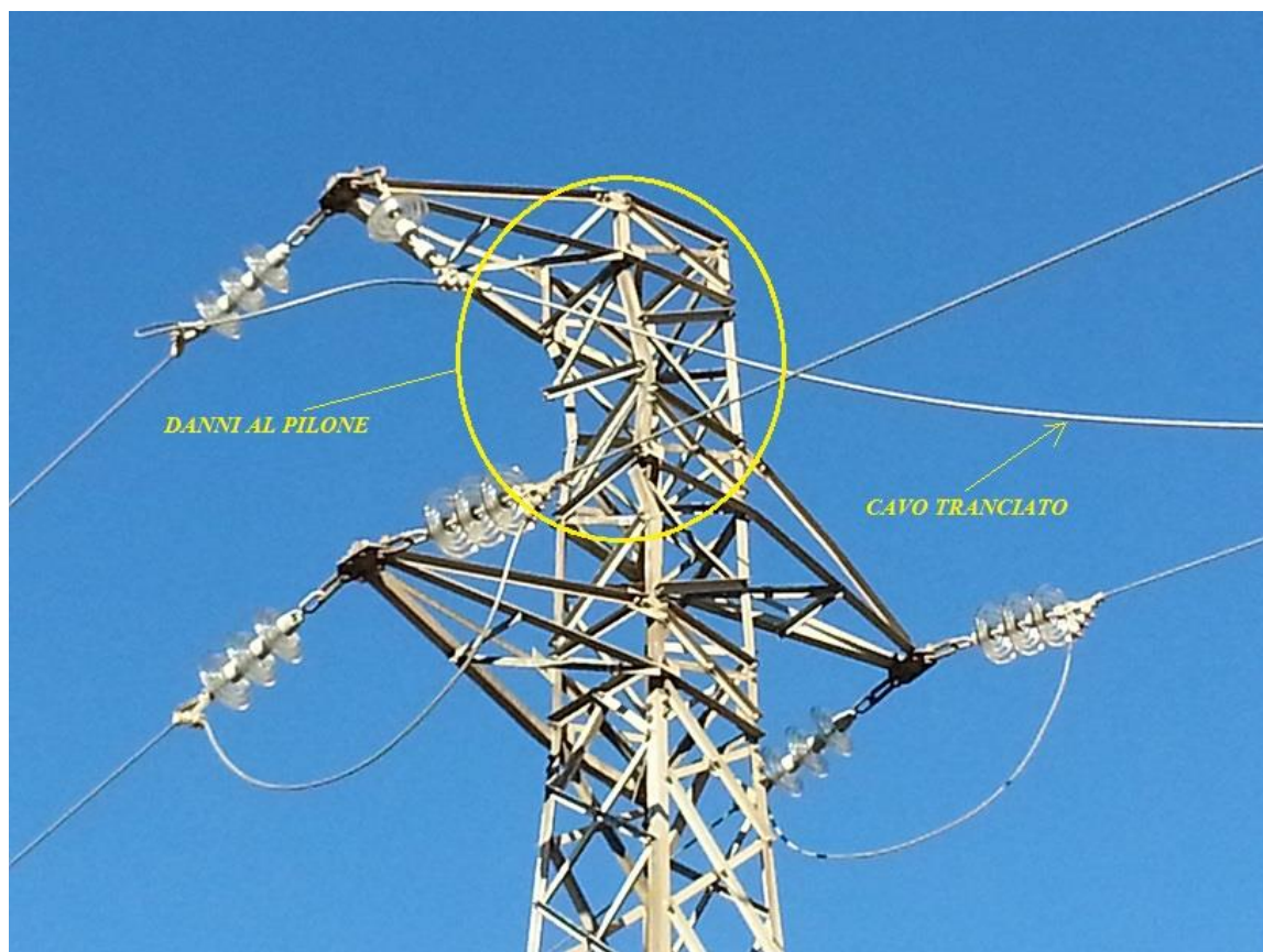
Foto 6: danni al traliccio dell'elettrodotto.
