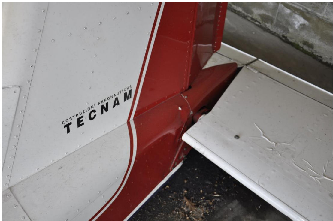
Foto 3: danneggiamenti da compressione presenti sui punti di contatto fra gli angoli interni del profilo di ingresso di entrambi gli stabilizzatori.
