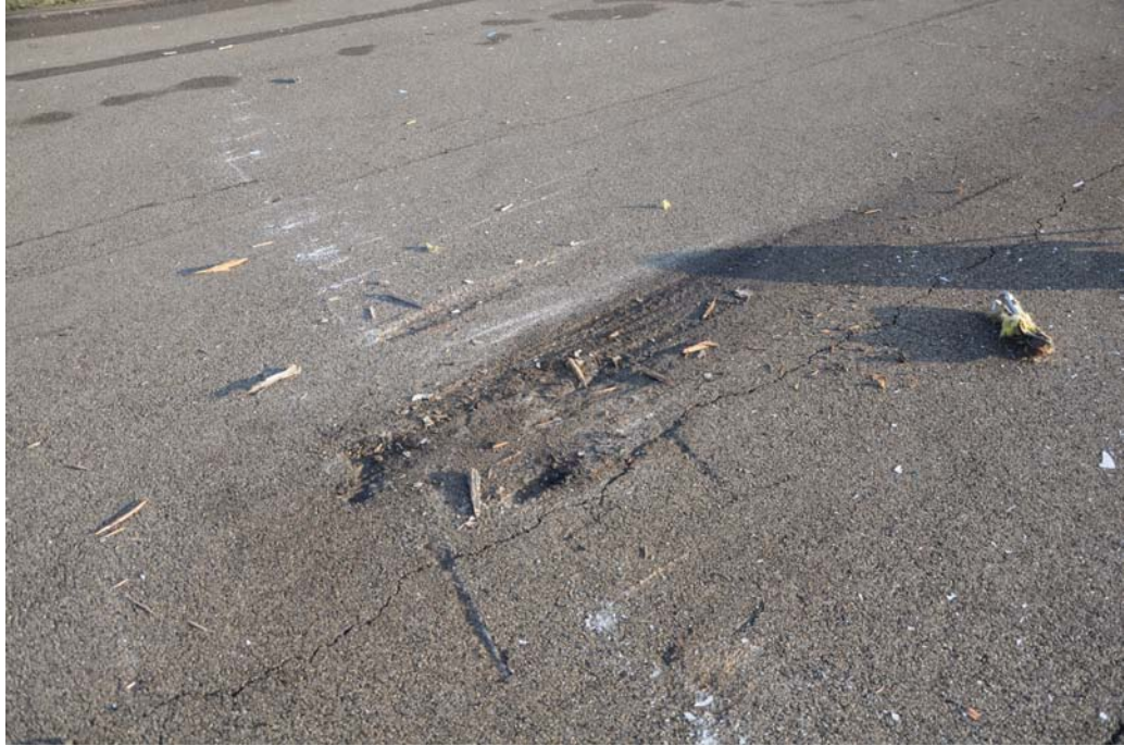
Foto 2: punto d'impatto e danni al manto superficiale della pista.
