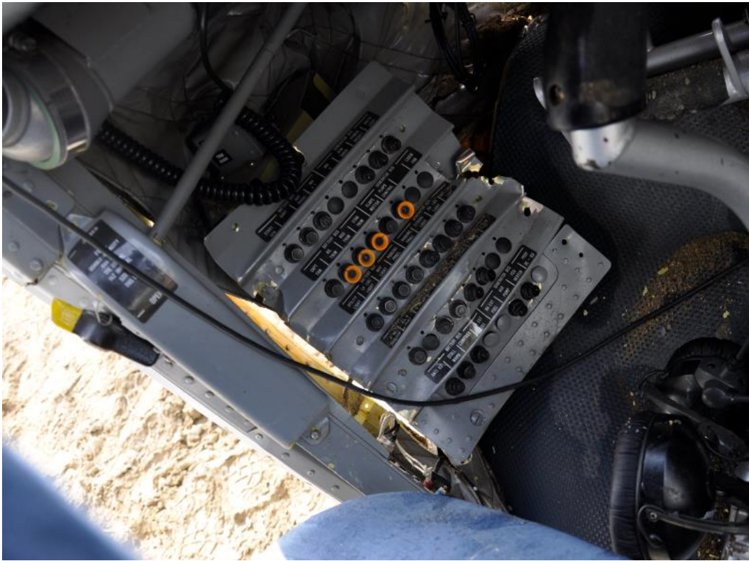
Foto 7: pannello fusibili a lato del sedile del pilota.
