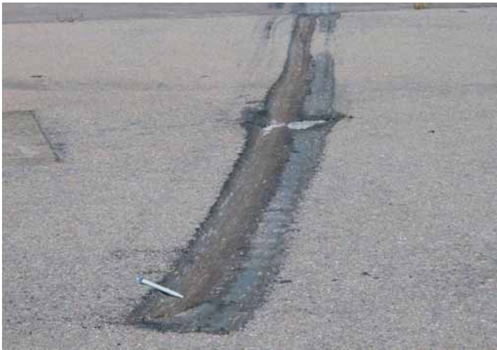
Solco nella pavimentazione.
