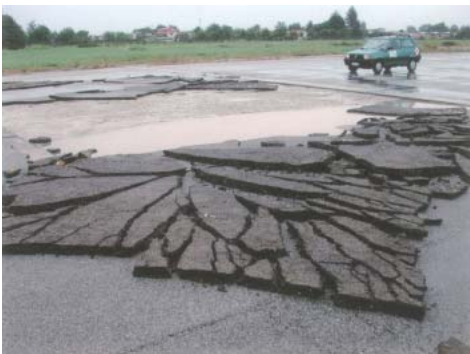
Particolare dei pezzi di asfalto divelti
