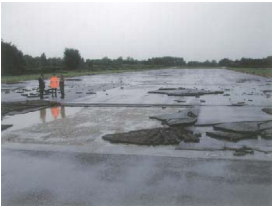
Particolare dell'asfalto divelto. La fotografia è stata fatta in direzione 25
