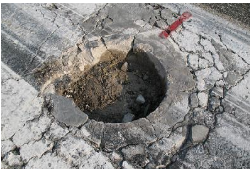
Foto 5: alloggiamento da cui si è staccata la plafoniera n. 43.
