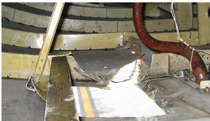
Foto 3: rottura centina della struttura di coda provocato dal passaggio del segnale.
