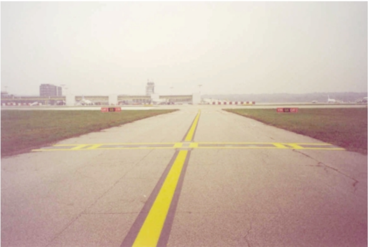
Raccordo GS - Segnaletica orizzontale priva delle indicazioni luminose previste per operazioni con bassa visibilità
