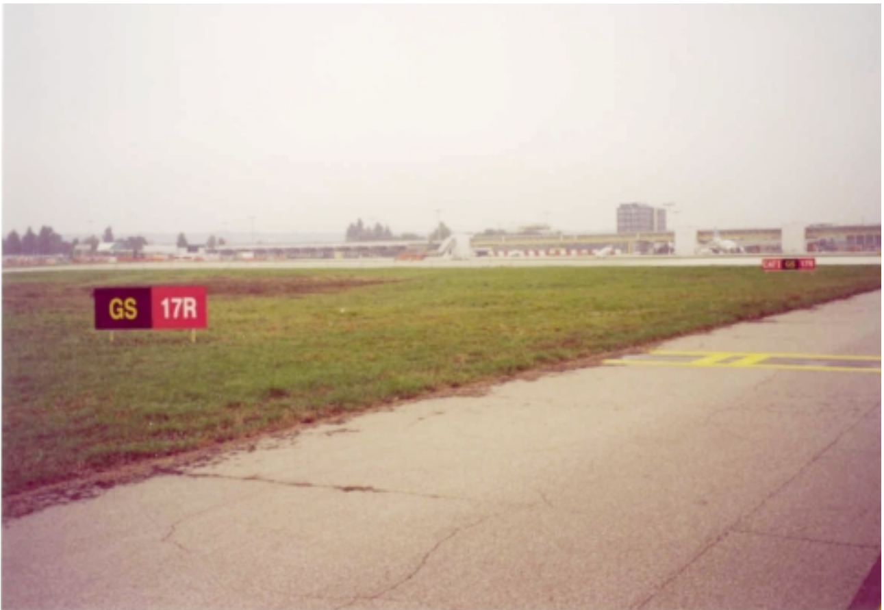
Raccordo GS - Segnaletica verticale non conforme ai requisiti previsti per operazioni con bassa visibilità
