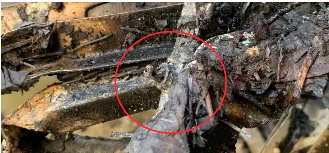
Foto 17: particolare della valvola fuel shut off rinvenuta ancora vincolata alla struttura.
