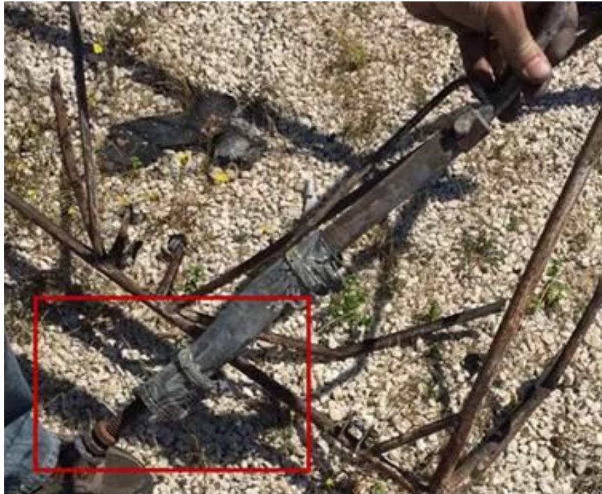
Foto: 23 particolare dell'attuatore flap.
