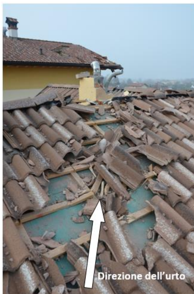
Foto 2: segni d'urto sui tetti delle abitazioni.
