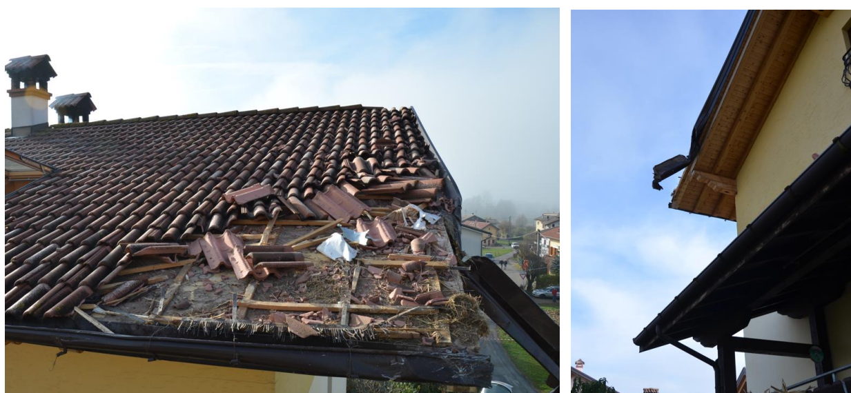
Foto 3 e 4: ulteriori danneggiamenti.
