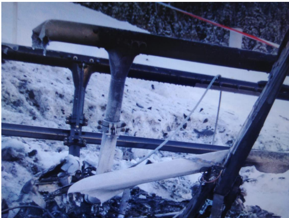
Foto 3: cavo metallico collegato al carrello a pattini.
