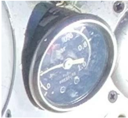
Foto 15: danneggiamento indicatore pressione alimentazione carburante.
